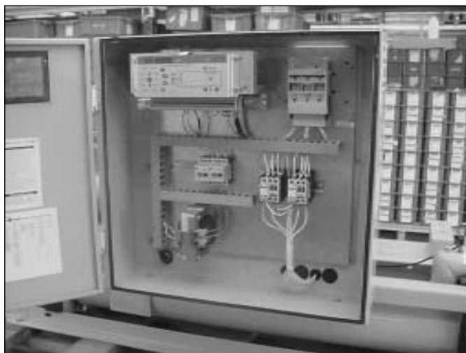
Figura 4 - Caixa de controles unidade 020
