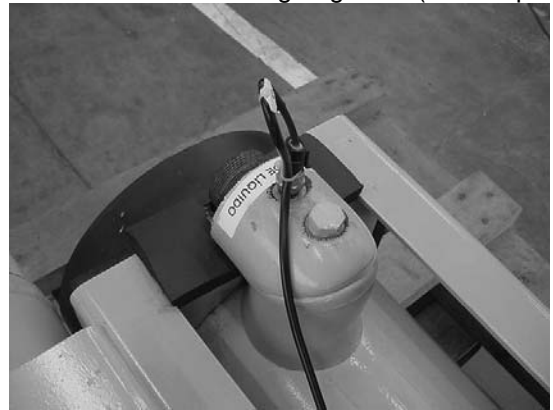
RT1 - Termistor de saída de água gelada (vista superior)
