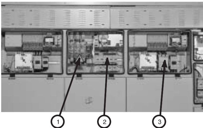
Caixa de controle
